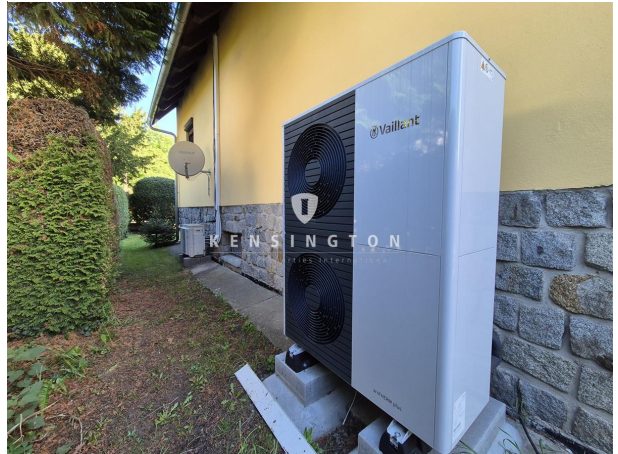
Wärmepumpe und Klimaaggregat
