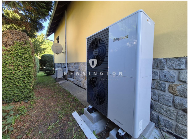
Wärmepumpe und Klimaaggregat
