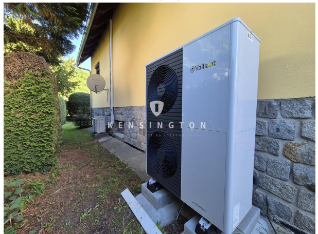
Wärmepumpe und Klimaaggregat
